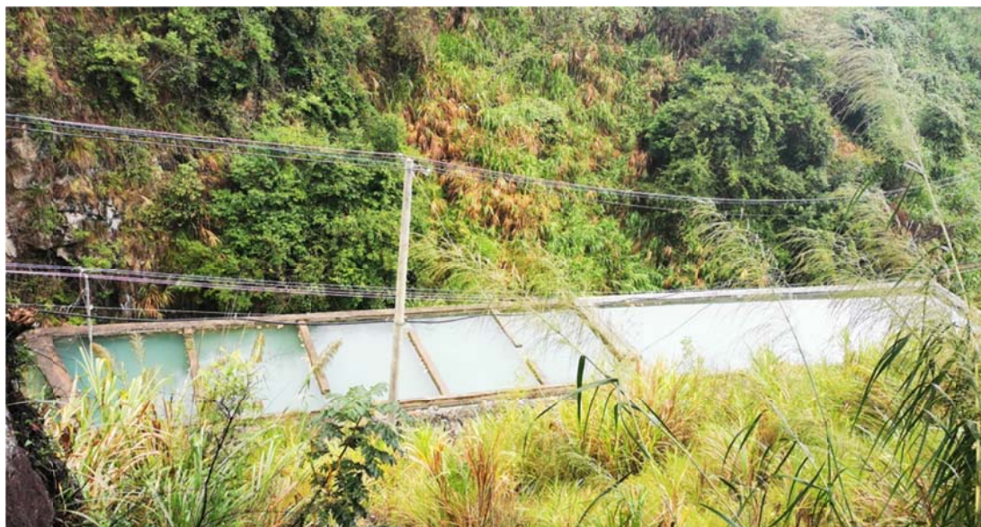
图 3 6 号矿井系统多级沉淀池
