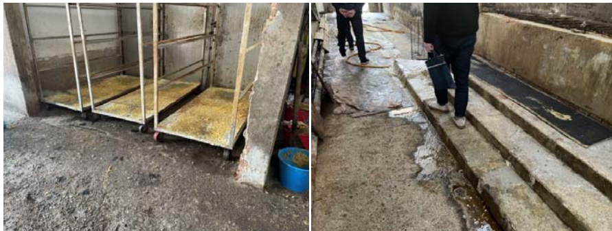
车间废水漫流，废水未得到有效收集
